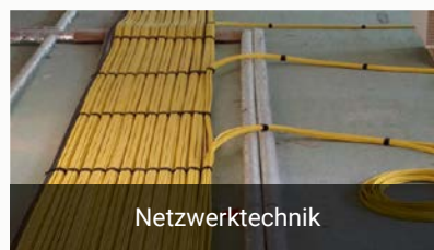
Stark- und Schwachstrom
